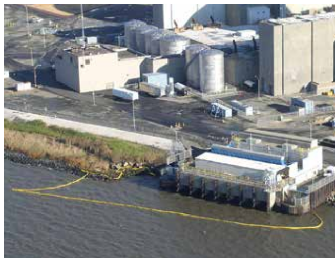
▲ 図13：発電所の冷却水取水装置の前に展張されたカーテン型オイルフェンス。
